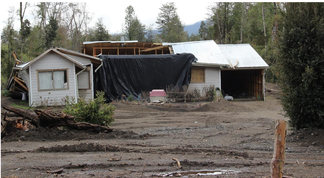
Figura 10. Colapso de techumbre por caída de cenizas – localidad de Ensenada
